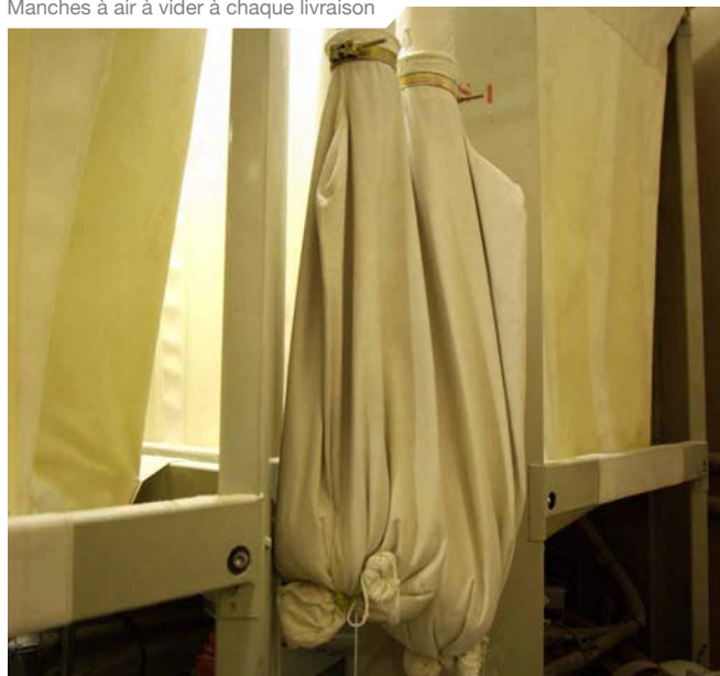
Manches à air à vider à chaque livraison
