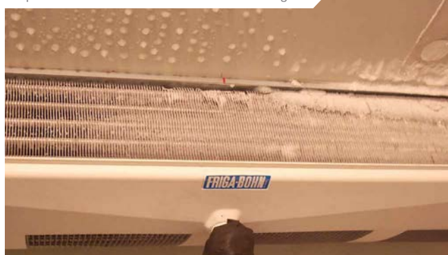
Évaporateur d'une chambre froide recouvert de givre
