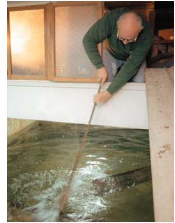
Sótano inundado debido al ascenso del agua de la napa freática.
