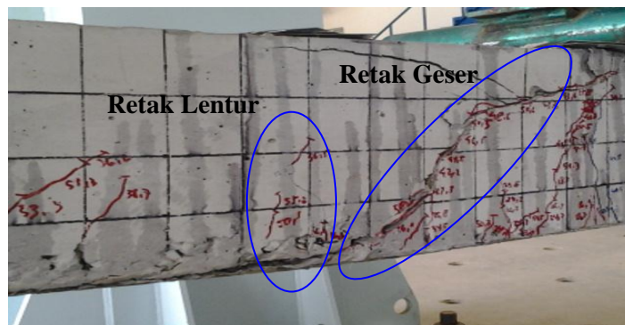
Gambar 4.22 Pola Retak Balok BGCG-1
