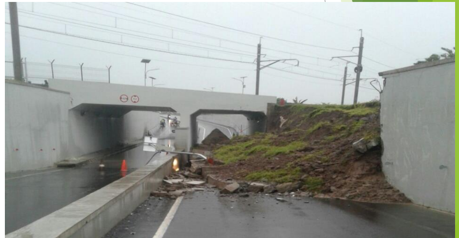
Kondisi saat Kecelakaan Konstruksi
