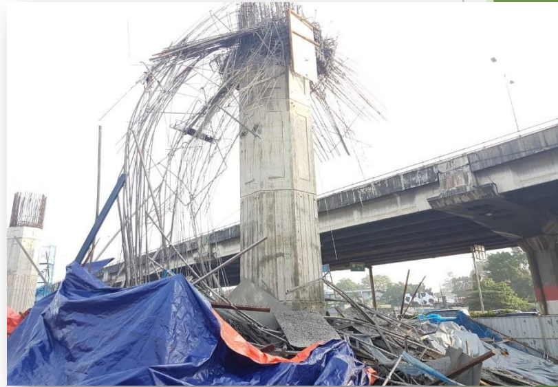
Kondisi saat Kecelakaan Konstruksi
