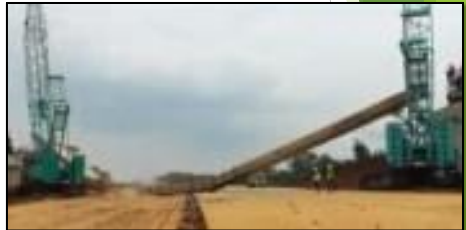
Kondisi Saat Kecelakaan Konstruksi
