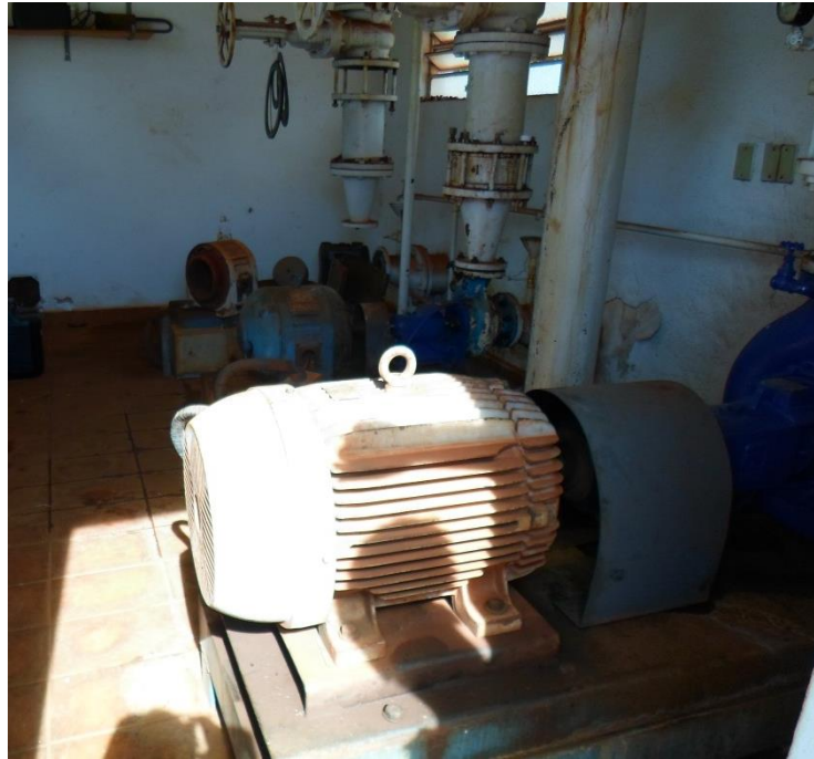
Foto 4.12 – Estação elevatória de água tratada
