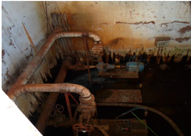
Foto 4.16 – Estação elevatória de esgoto
