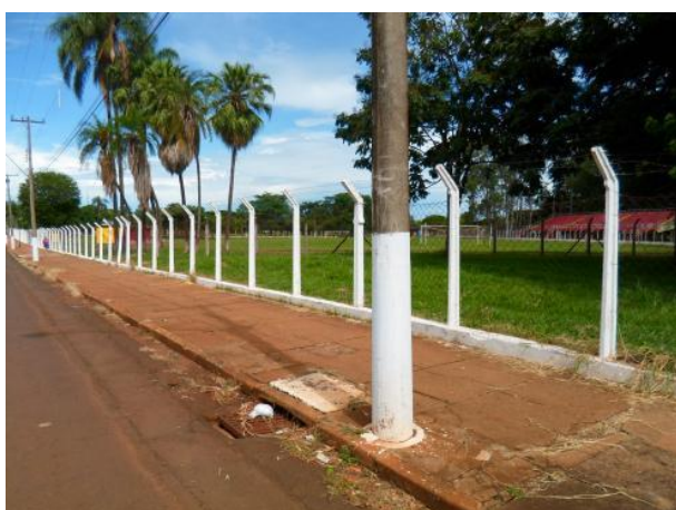
Foto 4.26 – Ponto de alagamento “campo de futebol”
