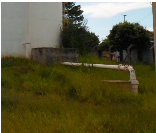
Foto 4.5 - Poço Monte Sereno
