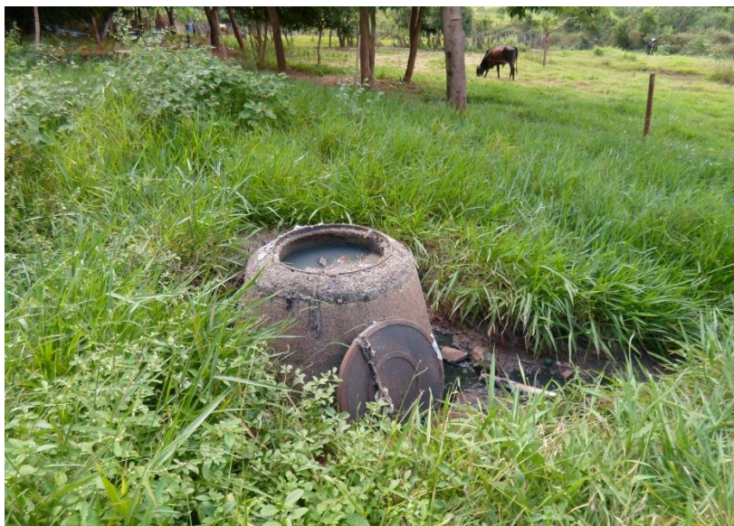
Foto 4.13 – Poço de visita transbordando
