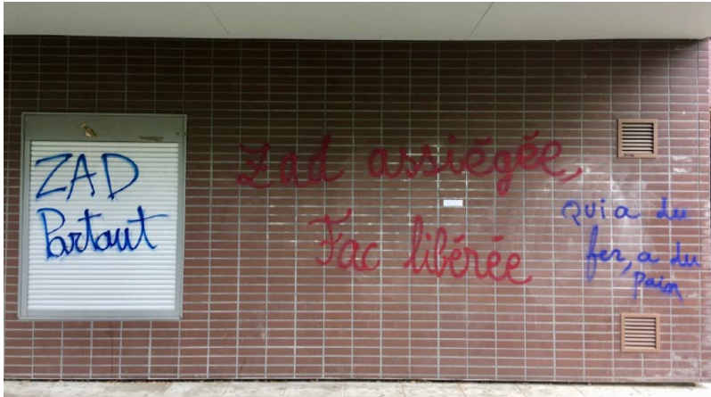
Figure 8. Graffiti, outside wall, Maison de l'Étudiant.
