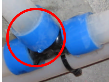
Figura -11- Pérdida en una instalación
