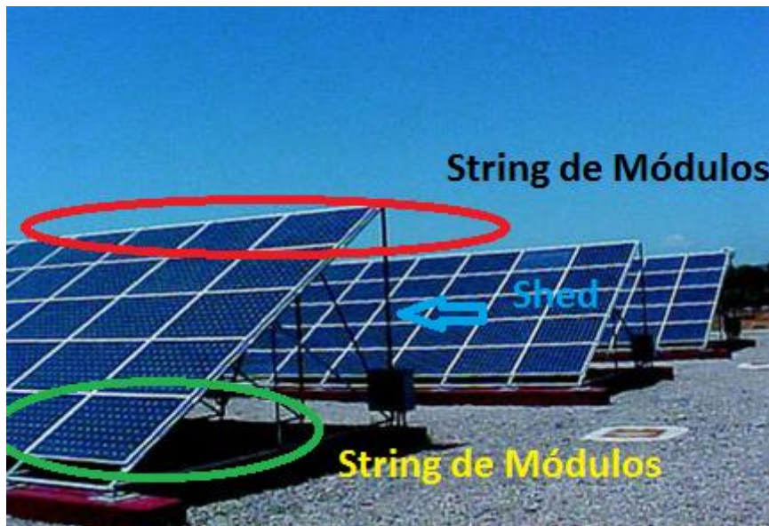
Figura 33: Distribuição mais Usual dos Módulos Fotovoltaicos nas Mesas - Adaptado [32].
