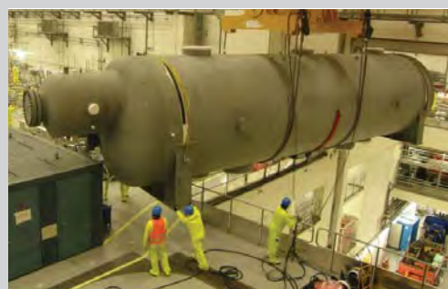
Moisture Separator Reheater (MSR)
