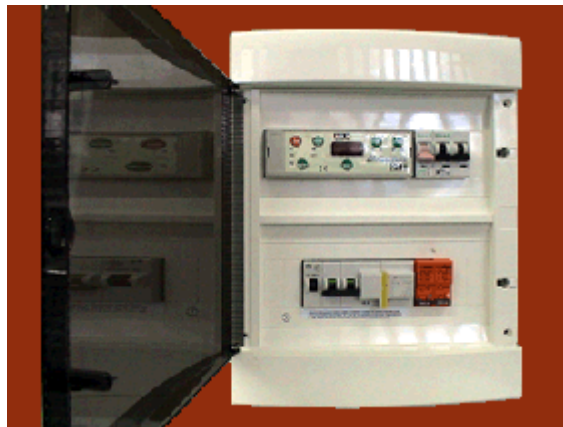
Imagen 9-10. Tablero del suministro eléctrico
