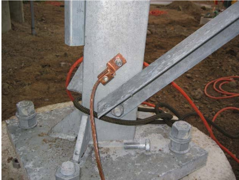
Imagen 8-6. Torre con un cable de cobre grueso conectado a tierra.
