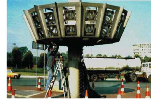
Figure 47 : Couronne d'éclairage du boulevard périphérique en position basse pour entretien – Porte Maillot, 1980
