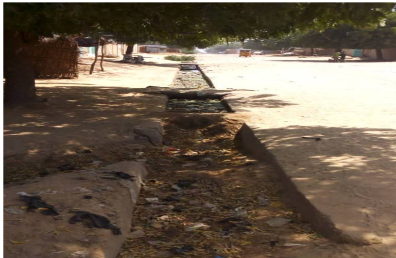
Photo 10: caniveau complètement bouché et rempli des débris le long du tronçon en projet
