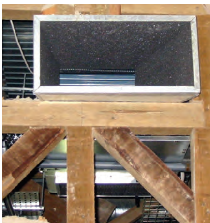
Adaptação de um frontal novo à passagem de tubagem de ar condicionado
