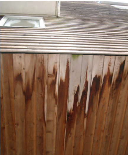
1 - Madeira com descoloração devido à presença de humidade
