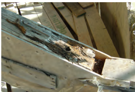
Apoio de asna degradada
