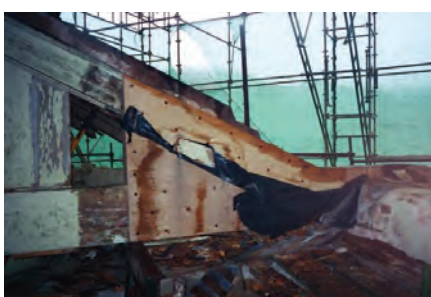
Fases de recuperação do apoio da asna
