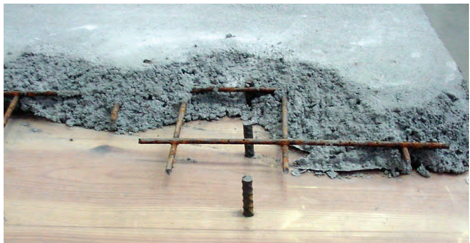
Ligação da madeira - betão com cavilhas. Visíveis para além das cavilhas, uma armadura construtiva e um plástico impermeabilizante
