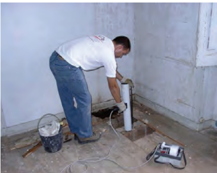
2 – Ensaio para avaliação da integridade dos vigamentos de madeira através da técnica da resistografia
