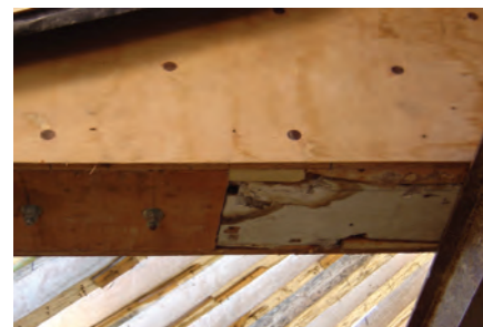
Fases de recuperação do apoio da asna
