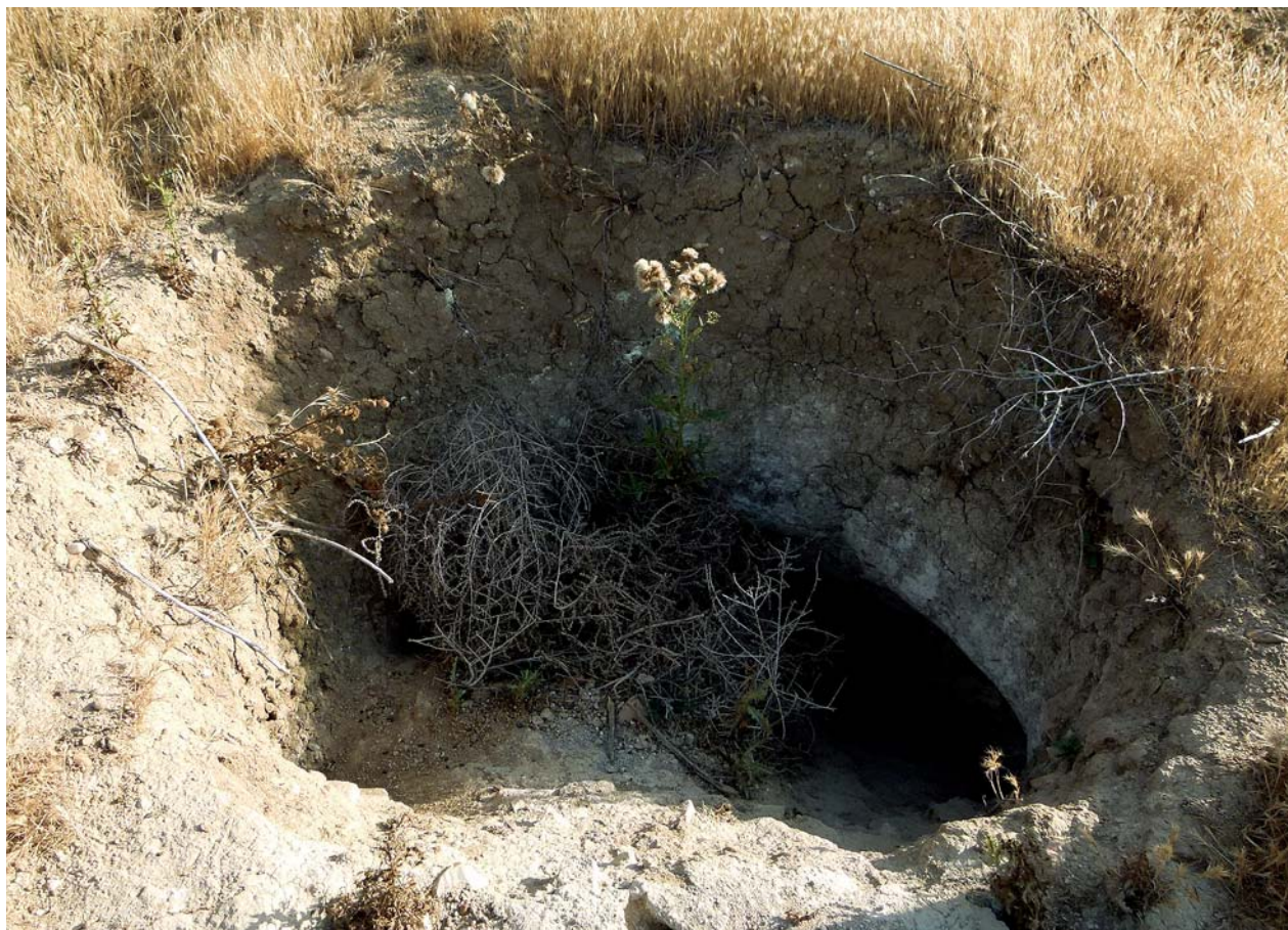
Fig. 16. Aspecto del respiradero de la bodega parcialmente tapado por derrumbe. / Wine-cellar ventilation shaft partially blocked by a collapse.
