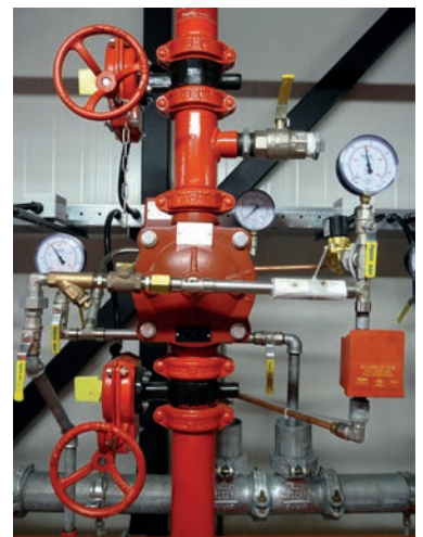
Vannes du système d'incendie
