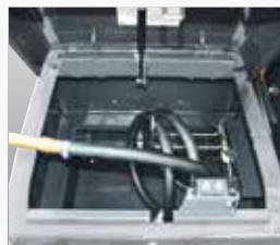
Pompe électrique de remplissage de carburant
