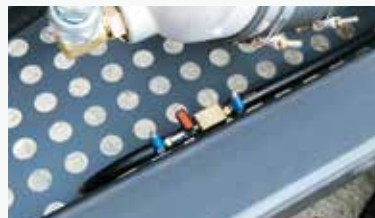
Robinet de vidange d'eau du réservoir de carburant
