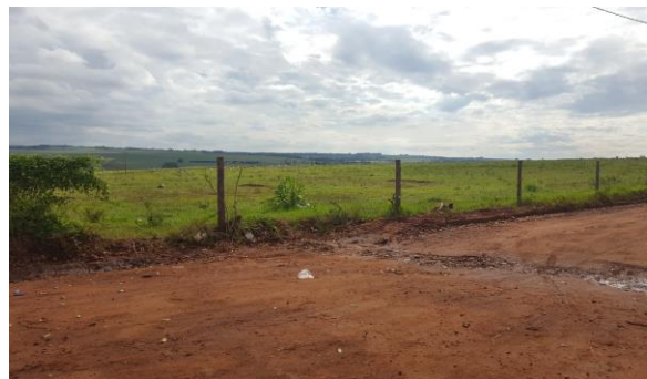
Foto 3.4 – Processo erosivo na rua Antônio Paladini
