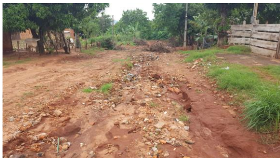
Foto 3.5 – Processo erosivo na Rua D, Vila Ferreira
