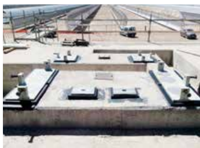
Placas de asiento (soleplates) para el anclaje de una turbina.
