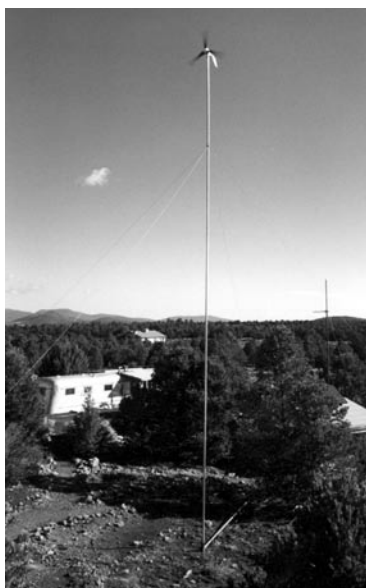
Una turbina eólica Southwest Windpower Air 303 de 300 watts es la única fuente de electricidad para un hogar en una zona remota al norte de Arizona.
