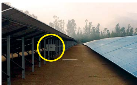
Stringbox Tableau de mesure et de protection des strings.
