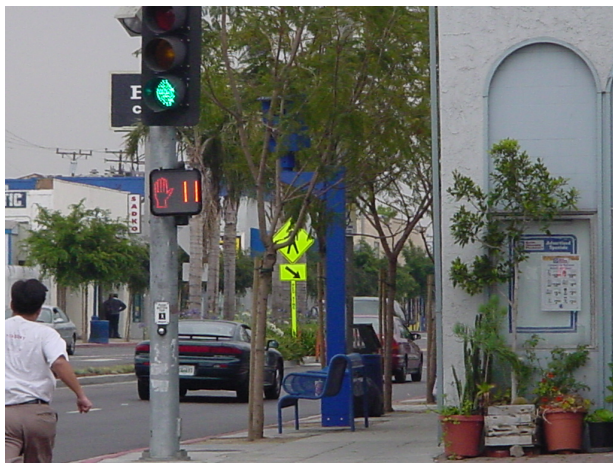
Pedestrian Signals / Semáforo de conteo
