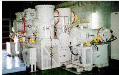
(d) Gas Insulated Switchgear (GIS) 72,5kV
