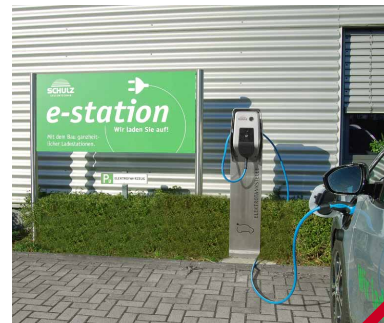
E-Ladesäulen in der Visbeker Firmenzentrale
