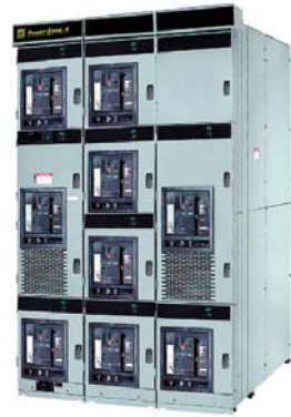
PZ4 Vista frontal compartimentos de interruptores
