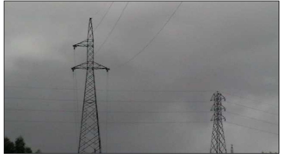
Infraestructura de Soporte Eléctrico
