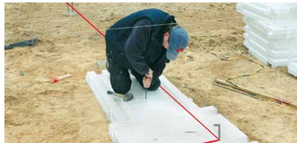
2 Vooraf uitzetten van de betonmaat via handig hulpmiddel in de bodemplaten. Hoeken vastzetten met haringen.
