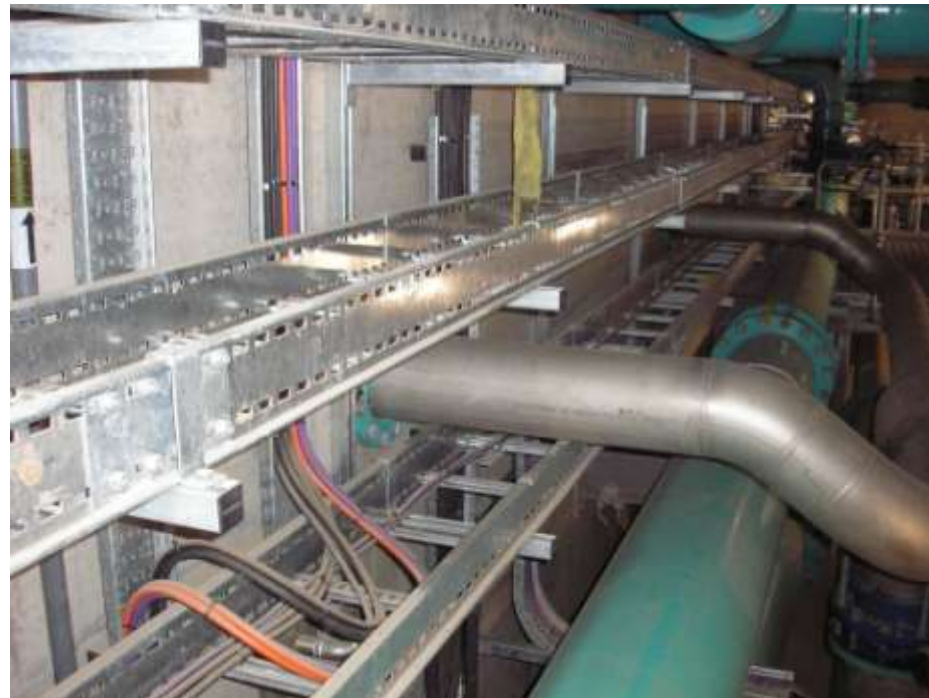
‘Underutilised’ cable tray
