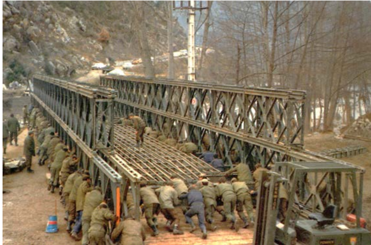
Puente Bailey del RING 4 (procedente de excedentes USA de la IIGM) Configuración doble-doble para sustituir a un puente civil destruido por una riada.
