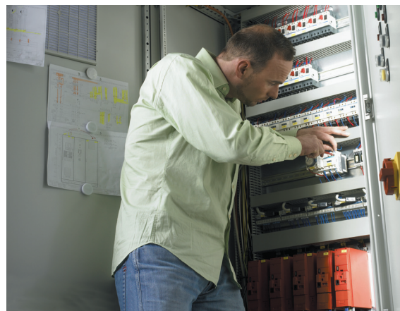
Fig. 1.1. La Electrónica estudia los principios en los que se basa el funcionamiento de los equipos con los que el técnico instalador y mantenedor deberá trabajar en su entorno profesional.
