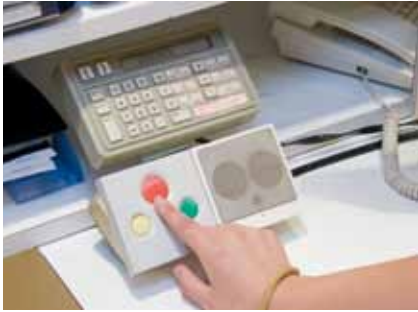
Fig. 1.5. Sistemas de intercomunicación con el control de enfermería.
