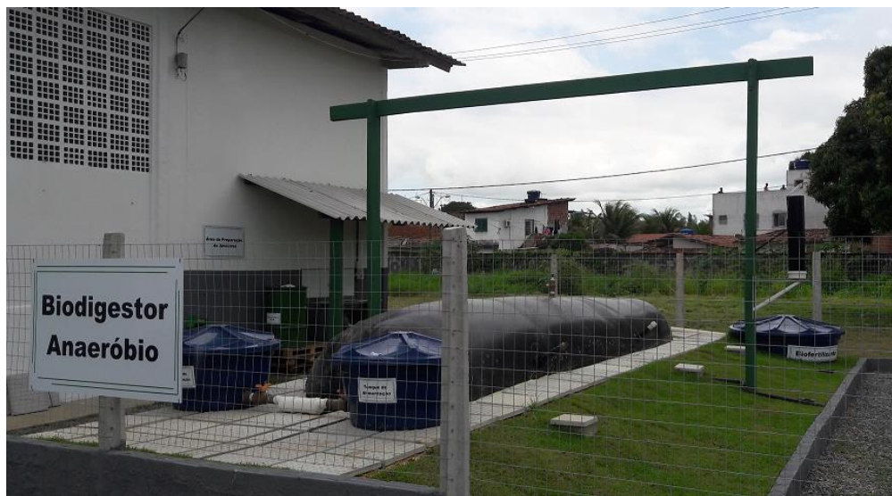
Figura 18-Biodigestor contínuo escala piloto (8m 3 ) instalado na Universidade Federal de Pernambuco.
