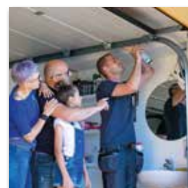
Servis in vzdrževanje vrat
