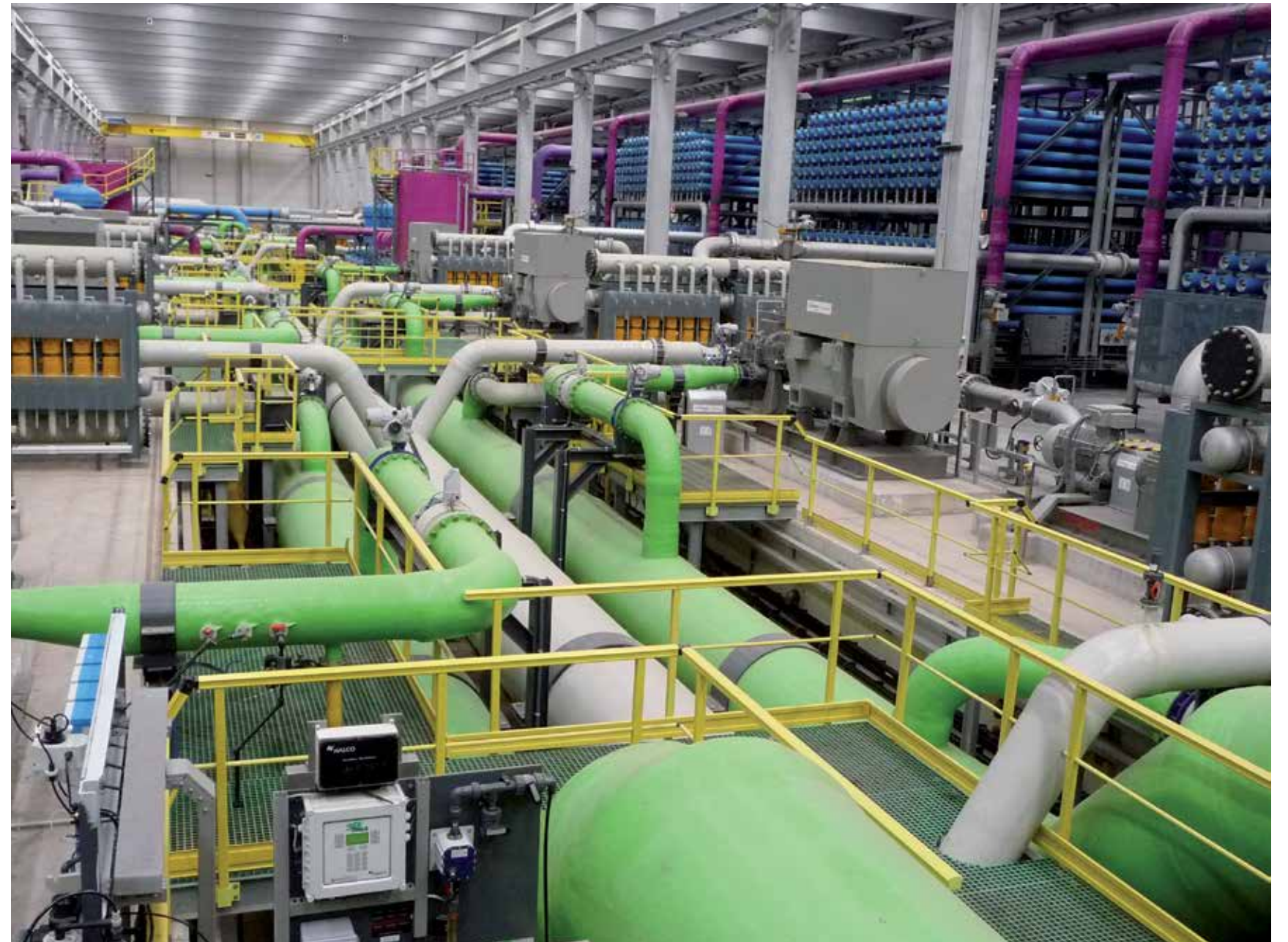
El Prat de Llobregat Desalination Plant, Barcelona, Spain
